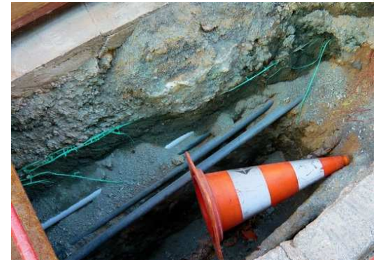
Infrastructures souterraines : Fourreaux
