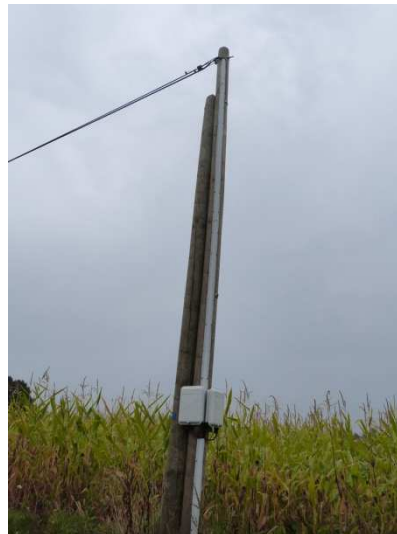
Infrastructures aériennes : poteaux
